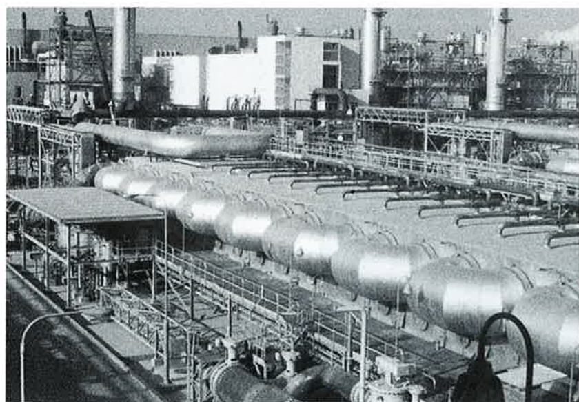
海水淡水化装置(サウジアラビア)
