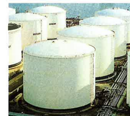
●純水タンク ●油タンク
